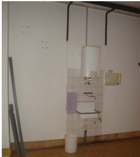
Innenansicht Aufputzinstallationen Nahversorger Bornemannplatz ( freiform.architekten )
