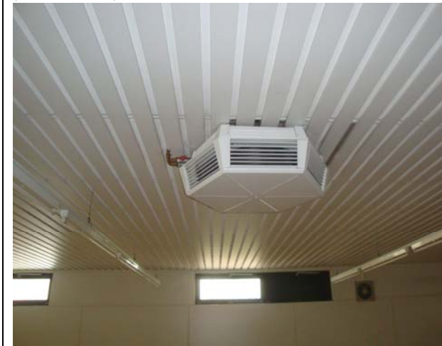
Decke Verkaufsraum mit Heizgerät im Nahversorger Bornemannplatz ( freiform.architekten )
